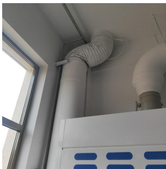
废气经管道收集 (3)
